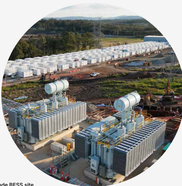
Supernode BESS site
